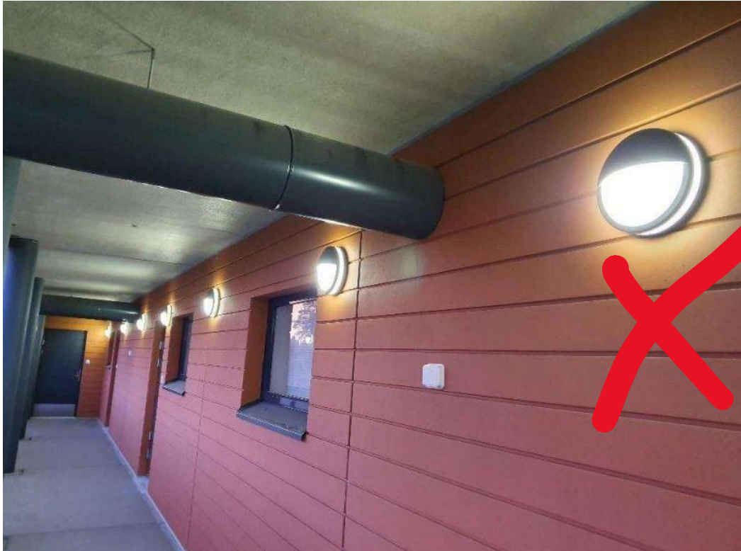
Bild 3. Det installerade lamporna på höghusets väggar skapar ett ljus riktat direkt mot grannhusens fönster vilken strider mot direktiven. Lamporna finns på alla 7 våningar och antalet är stort, ca. 120 stycken. Skenet vid grannhusens fönster är minst 5 gånger starkare än starkt månsken vid fullmåne.
