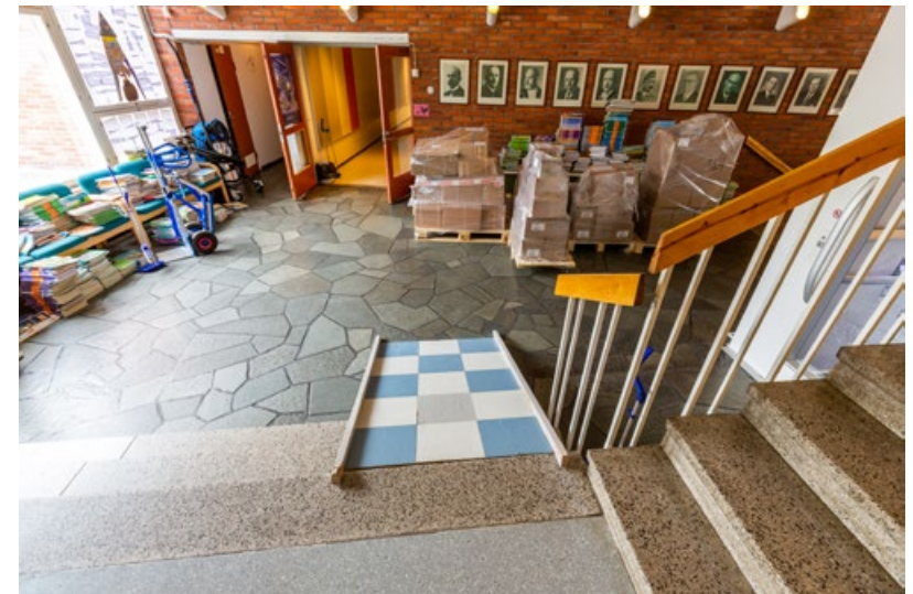
Jyrkkä luiska ja sen reunat aiheuttavat kompastusvaaran. Merkittävä huomiovärillä.
