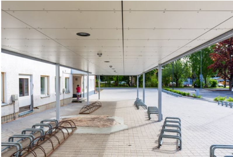
Kalliopinta voi aiheuttaa kompastuksen. Lisätään kontrastia laatoituksessa.
